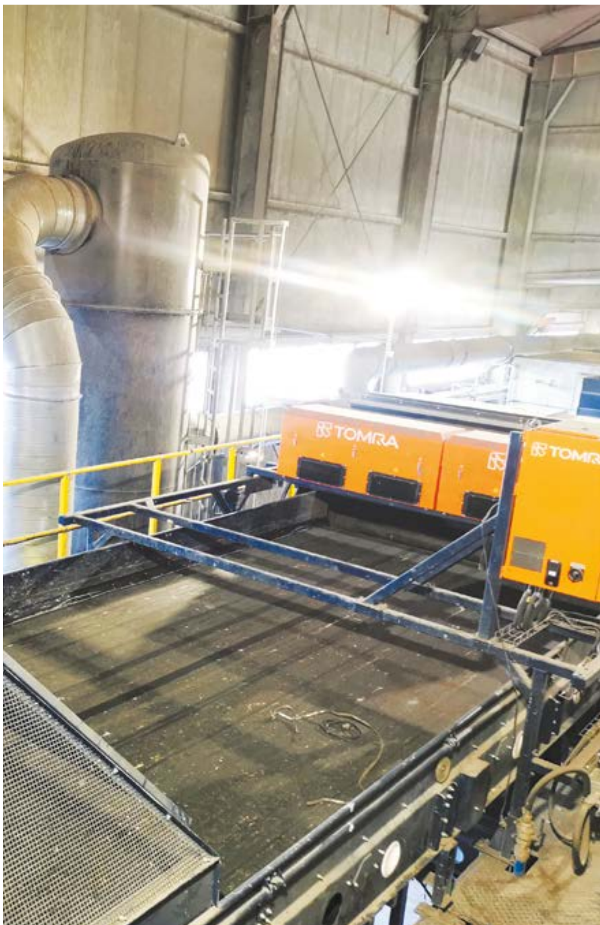
Powyżej i na stronie obok: Sortownia odpadów WPO Alba S.A. we Wrocławiu, jedna z najnowocześniejszych instalacji odzyskiwania odpadów w Polsce.
