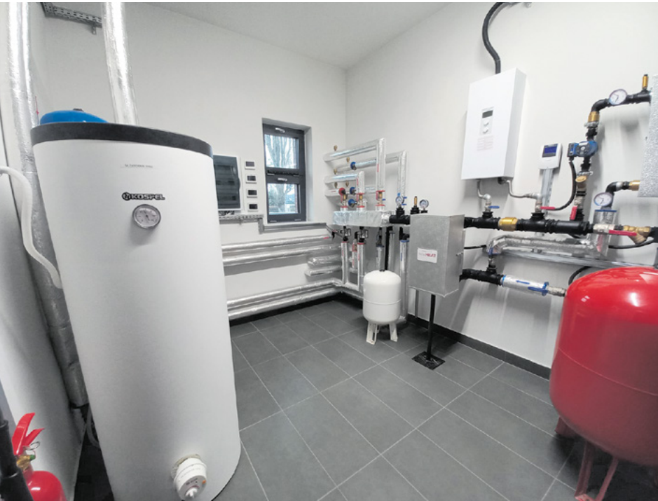
Budynek ogrzewany jest zestawem pomp ciepła
