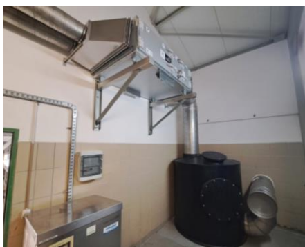
Fot. Filtr węglowy stosowany do eliminacji zjawiska korozji siarkowodorowej na oczyszczalni ścieków w Jurczycach.
