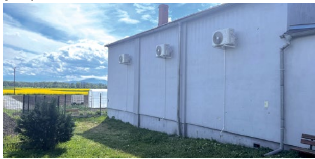
Klimatyzacja w świetlicy w Wojtkowicach
