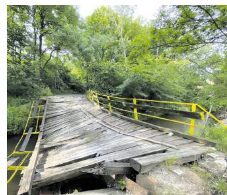
Zniszczony most w Bogdaszowicach.
